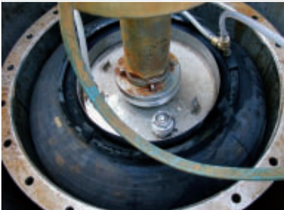
Abb. 7: Symmetrische Doppelkolbenkammer (oben) für den Einsatz in Vertikalfilterbrunnen DN 750 zur Intensiventnahme und Anpresstest zur Prüfung der Formstabilität (unten)
